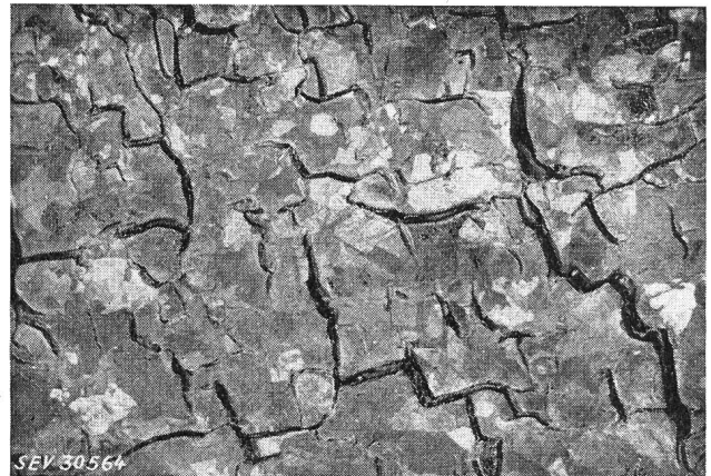
Fig. 4 Bleimantel-Zersetzung an einem 12\text{-kV-Kabel } 3 \times 185 \text{ mm}^2 (vergrössert)
