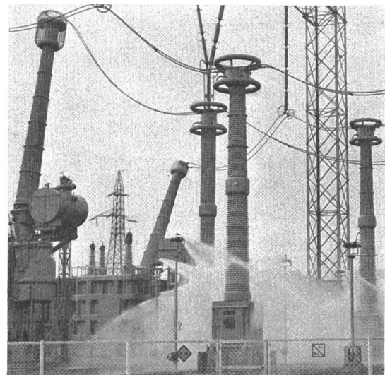
Fig. 13 Alimentation à 500 kV avec installation d'arrosage au High Voltage Power Laboratory à Takeyama Longueur des isolateurs 8 m
