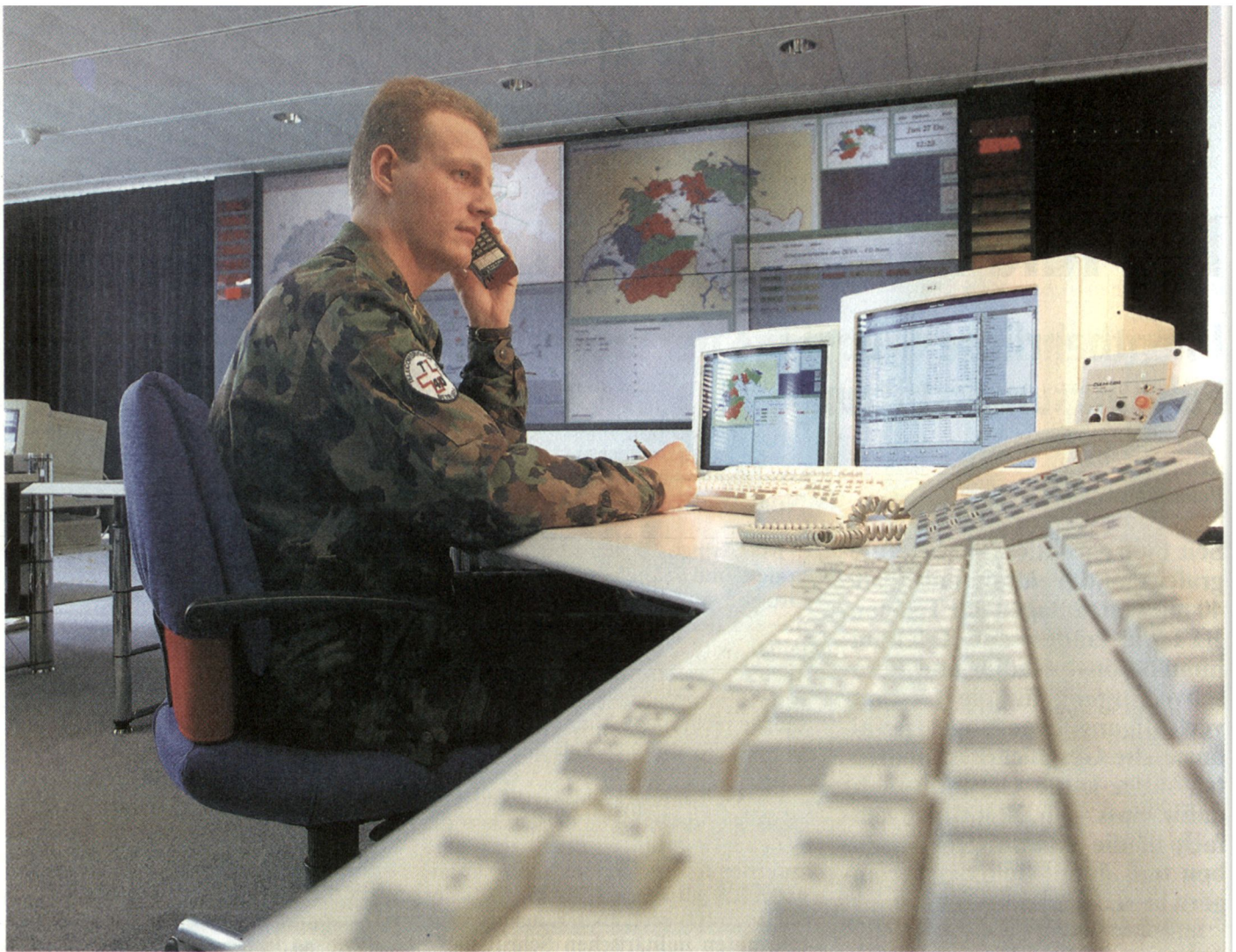
Das eigentliche Nervenzentrum: mittels Netzmanagement werden Zustand und Betrieb des gesamten Telecom-Netzes gesteuert und überwacht. (Aufnahmen GD PTT Reprrotechnik)
