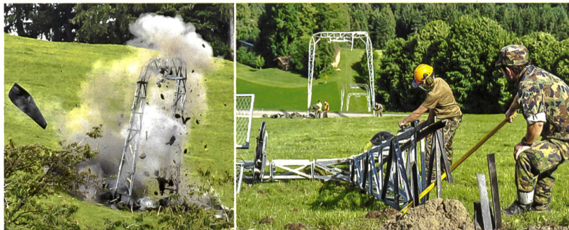
Das G Bat 23 sprengt Degersheim Skiliftmasten und Betonsockel. Bilder: Kdo Ter Div 4
