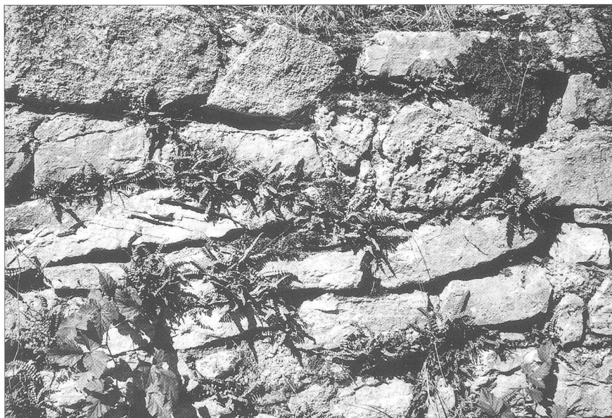
Dornach, Burgruine Dorneck, Zustand des Mauerwerks vor der Restaurierung.
