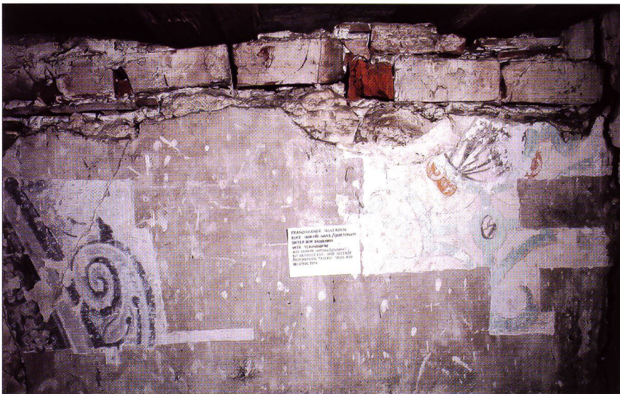
Abb. 39 Wandmalereifragmente an der Chorsüdwand, Zone zwischen dem westlichsten Chorfenster und dem Triumphbogen über dem Gipsgewölbe von 1824. Reste von Malereien aus verschiedenen Zeitepochen, links Teile der Fensterumrahmung von 1645, rechts eine ältere Beschlägwerkdekoration aus dem späten 16. Jahrhundert.
