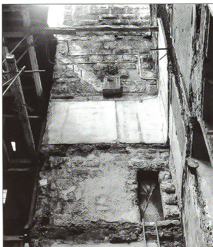
Abb. 5 Hocheingang im 2. Obergeschoss Südseite, Zustand vor der Zumauerung 1960 anlässlich des Neubaus des Hotels «Roter Turm». Gut erkennbar das aus gebosten Quadern sorgfältig geschichtete Türgewände und die mit Eisenblech beschlagene Tür.
