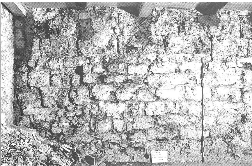
Abb. 4 Brandmauer West, 2. OG, Ausschnitt mit stark brandgeschädigter mittelalterlicher Mauer.
