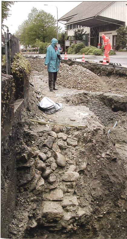
Abb. 62 Wolfwil/Kirche und Umgebung. Das Fundament der älteren Gartenmauer M15 unter der heutigen Treppe. Gegen Westen.
