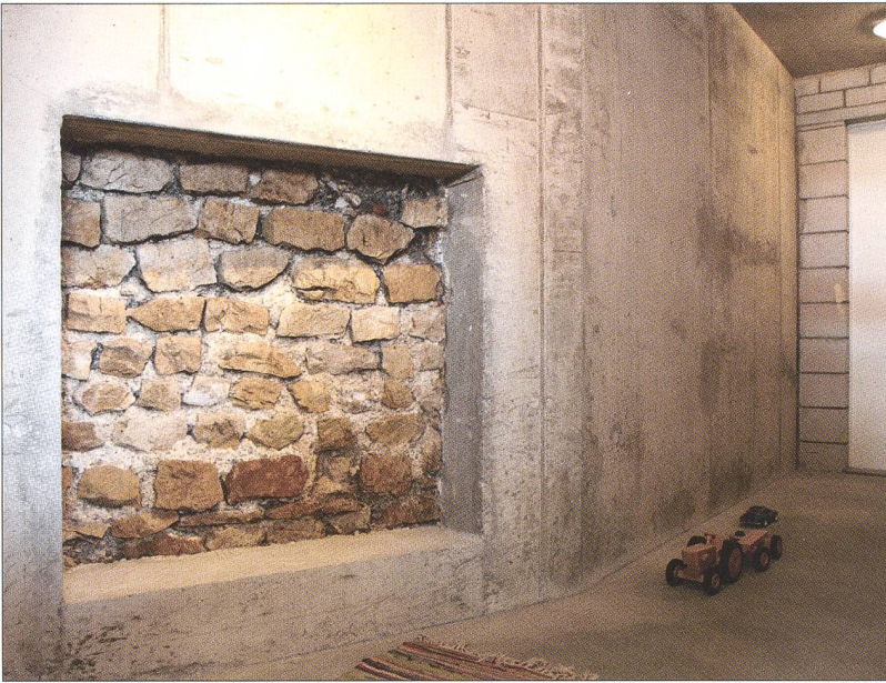
Abb. 8 Ein Fenster in die Vergangenheit – die im Keller sichtbare römische Mauer M5.
