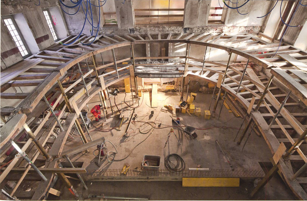
Abb. 25 Theatersaal, während der Bauarbeiten, 2013. Die Emporenbrüstungsbretter sind bereits demontiert. Gut sichtbar sind die Holzbalkenkonstruktionen der Emporen von 1778. Die schlanken Eisenstützen von 1856 ersetzen die quadratischen Holzstützen von 1778. Ihre Lage und Dimension ist an den zum Teil gefüllten Aussparungen im äusseren Holzbalkenring noch zu erkennen.
