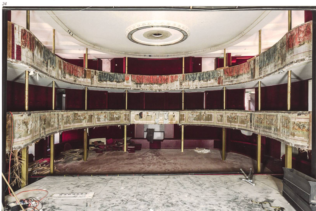
Abb. 24 Zustand der Emporenbrüstungen nach der Demontage der Stoffbespannung von 1936 und einer ersten partiellen Freilegung des oberen Rangs.
