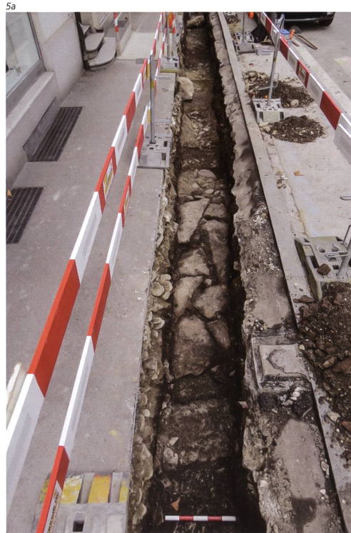
Abb. 5 a Gebäude I in einem Werkleitungsgaben im Jahr 2017. b Drei Jahre später kam in einem Leitungsgaben unmittelbar daneben die Fortsetzung von Gebäude I zum Vorschein. Gegen Norden.
