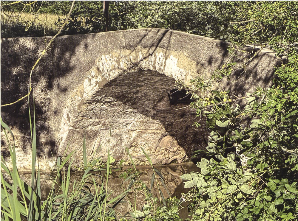
Abb. 17 Untersicht und Seitenansicht des Gewölbes mit neu ausgefugtem Mauerwerk sowie neu verputzter Seitenmauer. Foto 2021.
