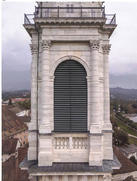
Abb. 10 Solothurn, Turm der St.-Ursen-Kathedrale. Ansicht der Glockenstube nach der Erneuerung der Jalousien.
