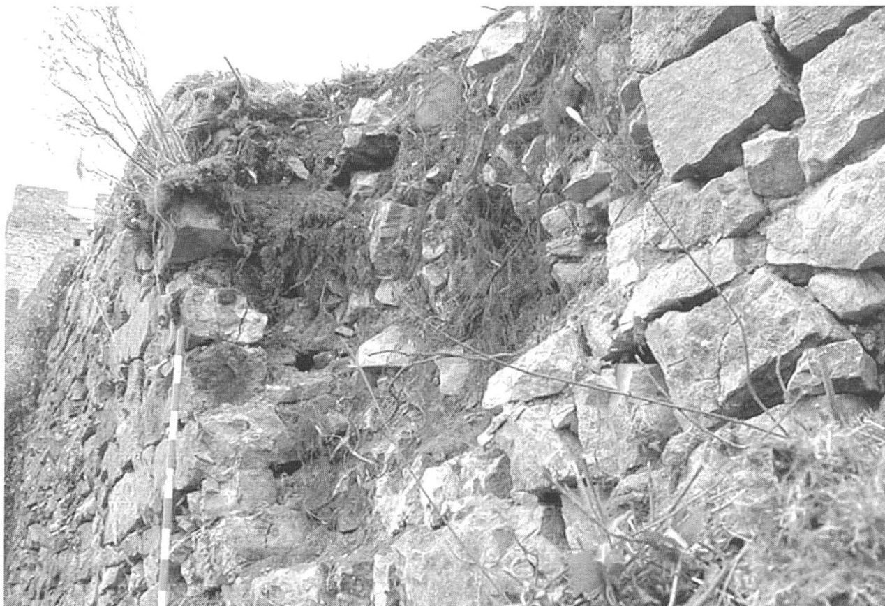
Abb. 7: Waldenburg, Schloss Waldenburg. Der Mauerausbruch am «Neuen Schloss». Es ist deutlich erkennbar, dass auch das umliegende lockere Mauerwerk erneuert werden muss.
