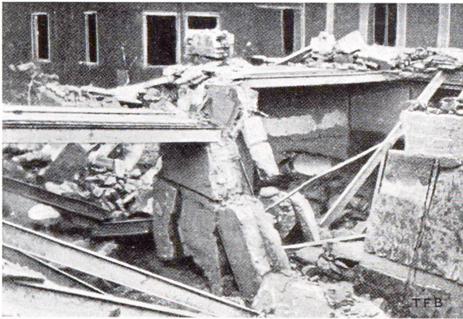
Fig. 6. Vue d'une partie du bâtiment de fabrique détruit au moyen de mines. (d'après E. Stettler, voir bibli.).
