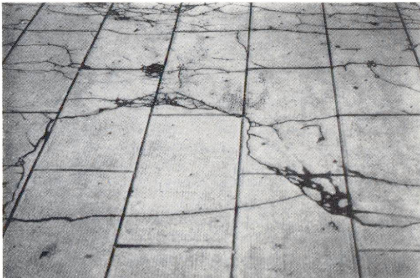
Fig. 3 Destruction d'un trottoir en béton sous l'action combinée du retrait et du gel
