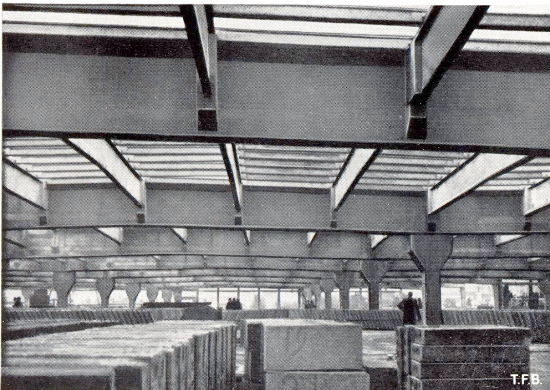
Fig. 8 Fabrique de coton à Gand (Belgique). Vue l'intérieure, avec fermes pannes et chevrons précontraints par le système Magnel
