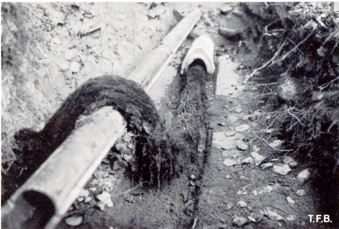
Fig. 2 Queue de renard autour d'un câble de 50 000 volts
