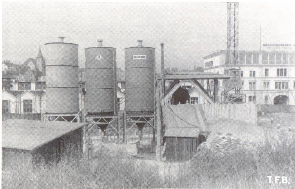
Fig. 6 Groupe de silos à ciment sur un gros chantier
