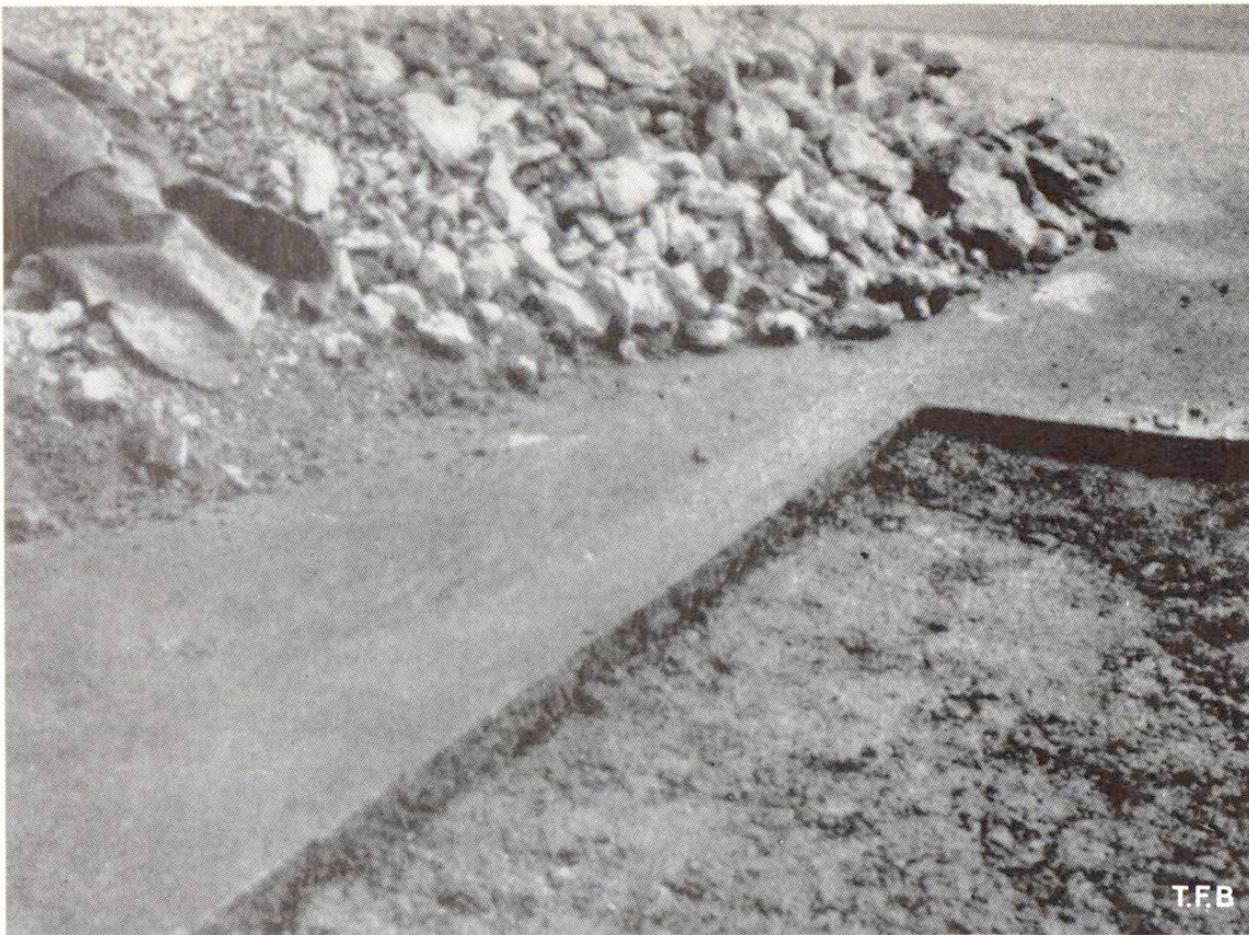
Fig. 4 Réparation d'un sol en béton. Repiquage arrêté par des faces perpendiculaires à la surface du revêtement et formant des arêtes vives
