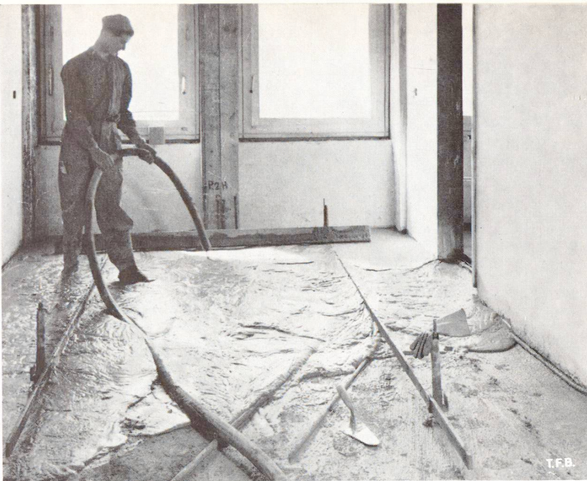
Fig. 6 Mise en place de béton cellulaire pour l'isolation d'un plancher (Photo: Engler, Winterthur).
