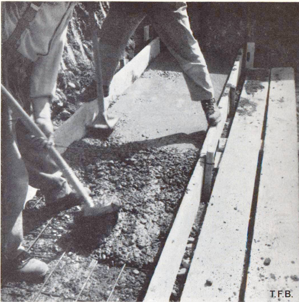
Fig. 9 Une faute encore trop souvent commise lors des bétonnages à la campagne: un béton trop liquide
