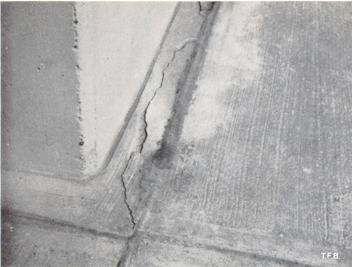
Fig. 5a et b Rupture du béton d'un revêtement le long d'un mur (voir aussi fig. 2). Le joint devrait être exactement au droit du bord de la fondation alors qu'il se trouve 5 mm à côté. Il a suffi d'un léger soulèvement du dallage par le gel pour provoquer ces dégâts. La photo de droite montre très clairement le cas; on y voit même la trace du carton bitumé à côté du joint superficiel
