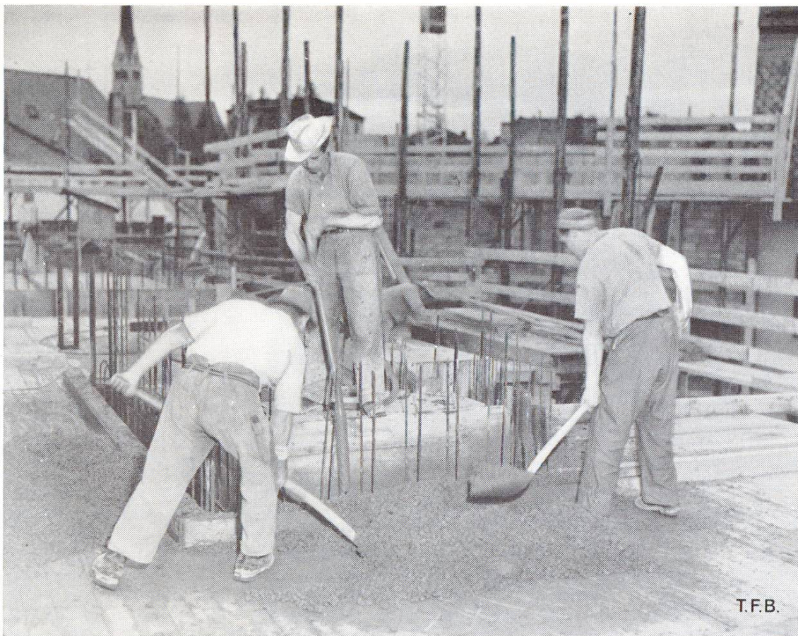
Fig. 4 Si la hauteur de chute est grande ou si l'armature est dense, le béton doit être mis en place à la pelle par petites quantités
