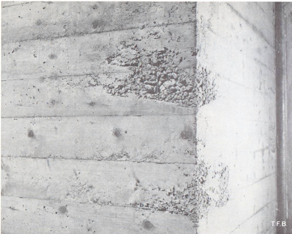
Fig. 3 Nids de gravier dans un angle de mur. La mise en place du béton doit être particulièrement soignée en de tels endroits
