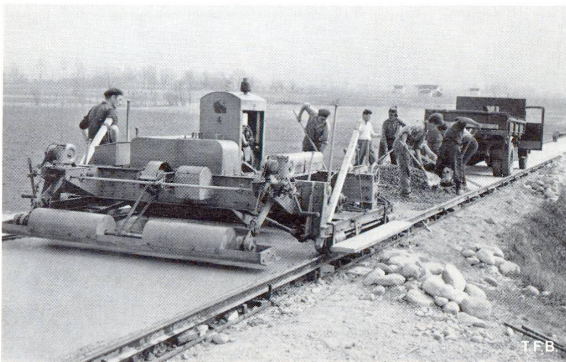
Fig. 4 Machine pour la construction d'un chemin en béton. La dalle a normalement 14 cm d'épaisseur, elle est légèrement armée. L'avancement journalier du bétonnage est de 150 à 250 m de chemin
