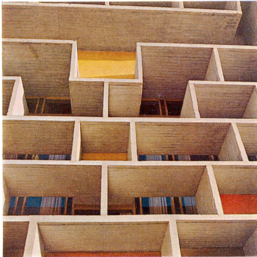
Fig. 2 Détail du « brise soleil » de la façade du Palais de Justice. On distingue nettement les dessins laissés par les coffrages en bois brut
