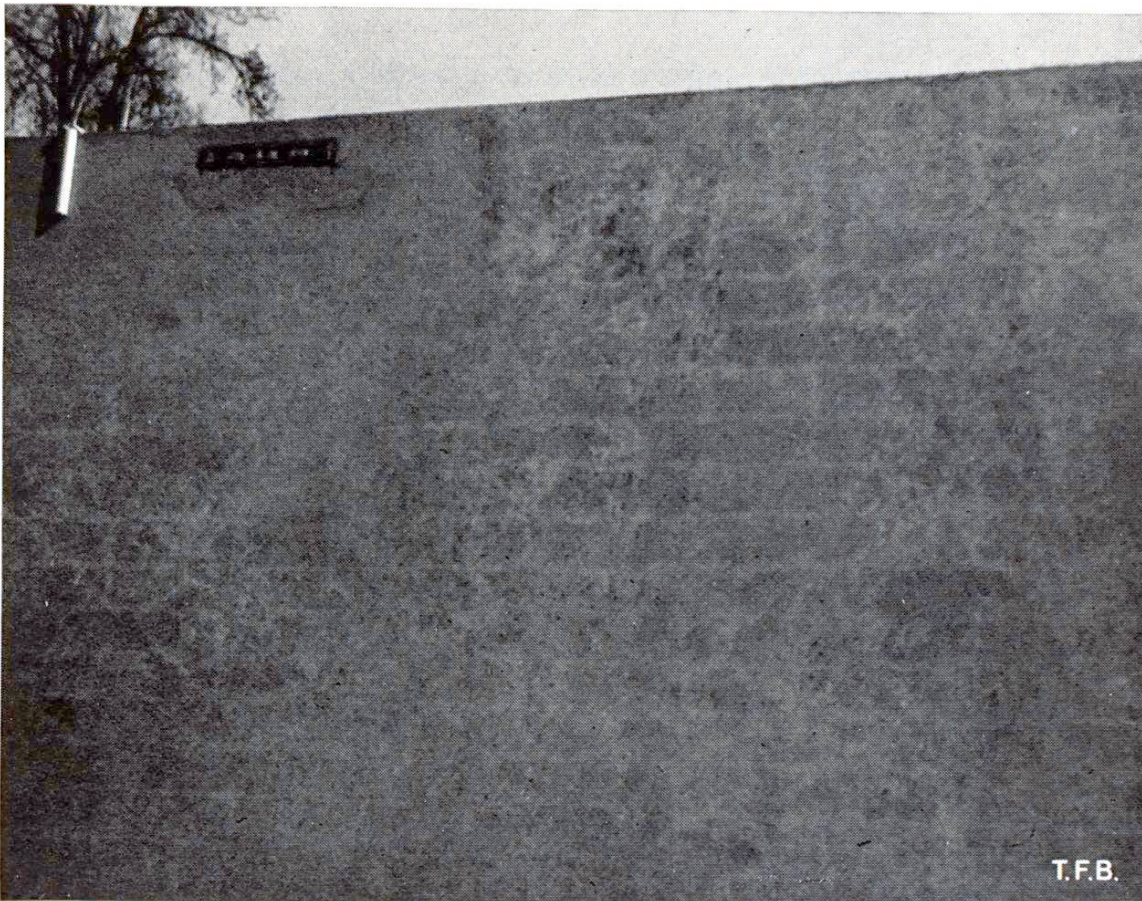
Fig. 4 Image superficielle de l'armature dont les causes sont les mêmes que celles que mentionne la figure 3 (Ségrégation de la pâte de ciment entre armature et coffrage).
