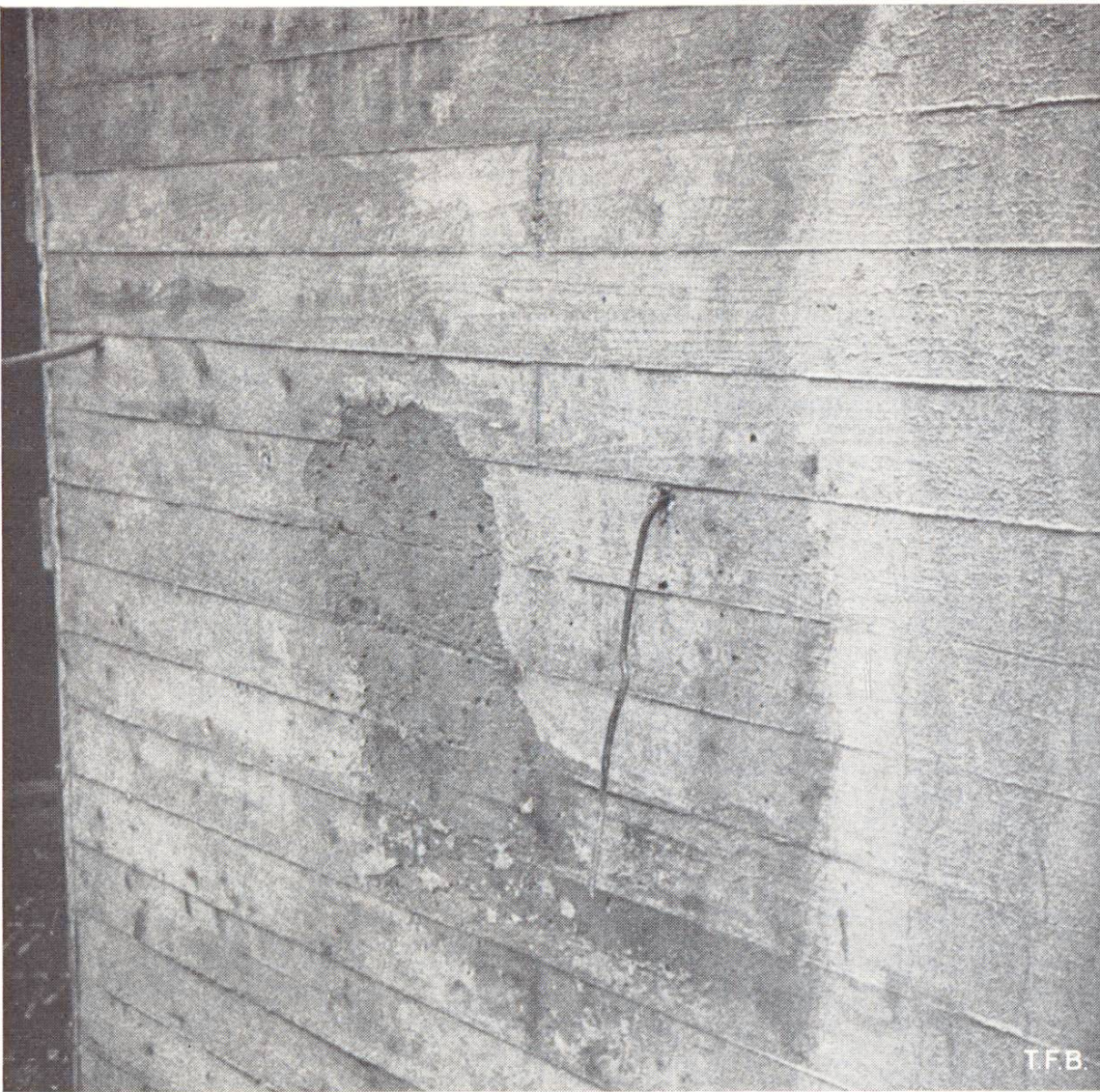
Fig. 6 Importants décollements de la pellicule de ciment dus à l'action du vibreur dans une couche déjà trop durcie.
