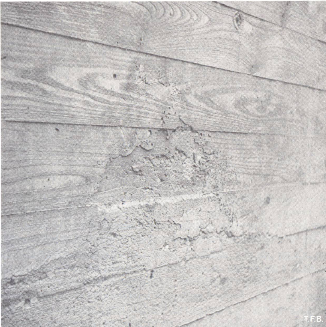
Fig. 5 Décollements étendus de la pellicule de ciment dus à des déplacements du coffrage lors de la mise en place et de la vibration de la couche suivante (coffrage mal étayé, éventuellement première couche mal vibrée).
