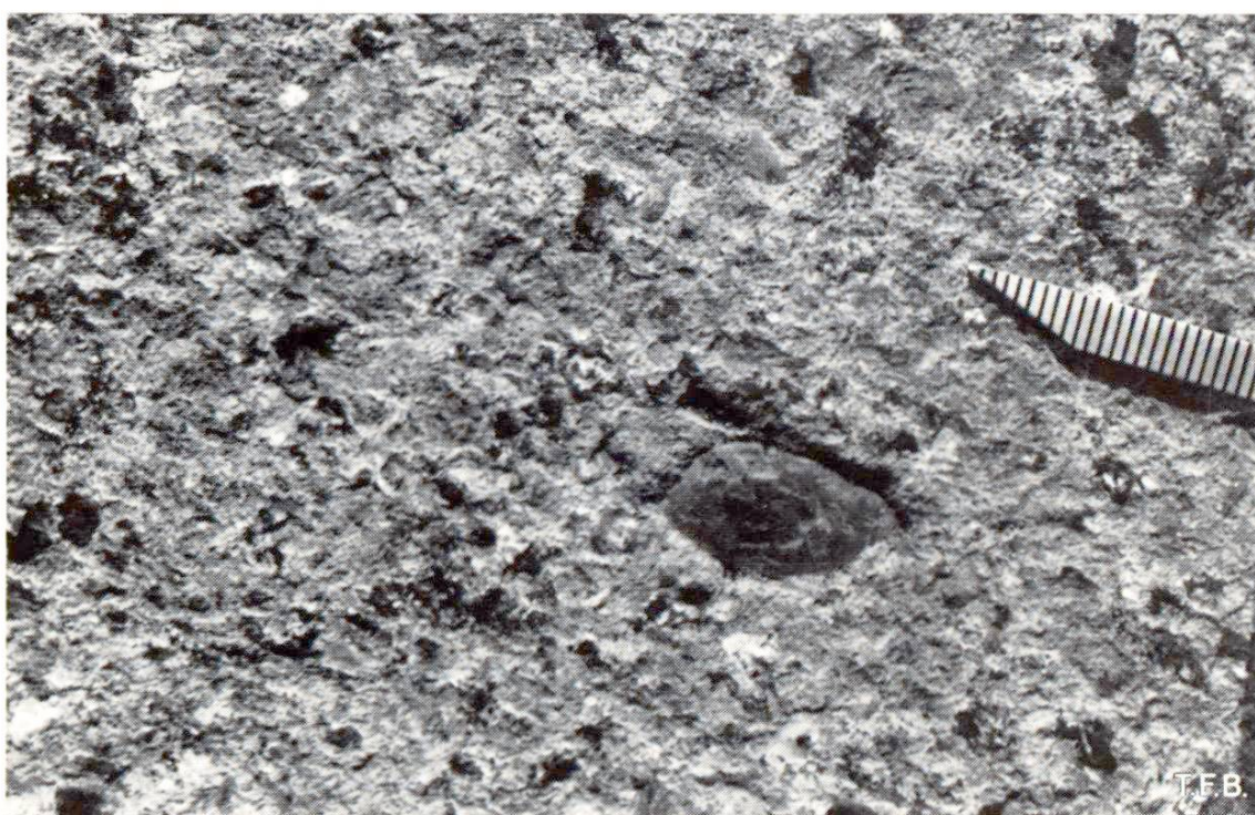
Fig. 8 Etat d'une surface de béton après élimination complète du dépôt de caoutchouc et léger ravivage de la rugosité. Le béton lui-même n'est pas attaqué d'une façon pouvant nuire à l'intégrité du revêtement ou à la forme de la structure de sa surface.
