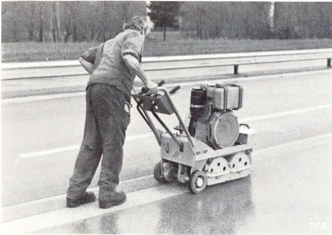
Fig. 1 Traitement de surface du revêtement en béton d'une autoroute. La machine ravive uniformément et régulièrement la rugosité de la surface par des chocs libres à effet contrôlé. Elle est pourvue en outre d'un dispositif permettant une correction automatique de la planéité de la surface, par passes successives, ainsi que d'un réglage de l'avance automatique (fournisseur : Fabrique de machines von Arx, Sissach, Suisse).
