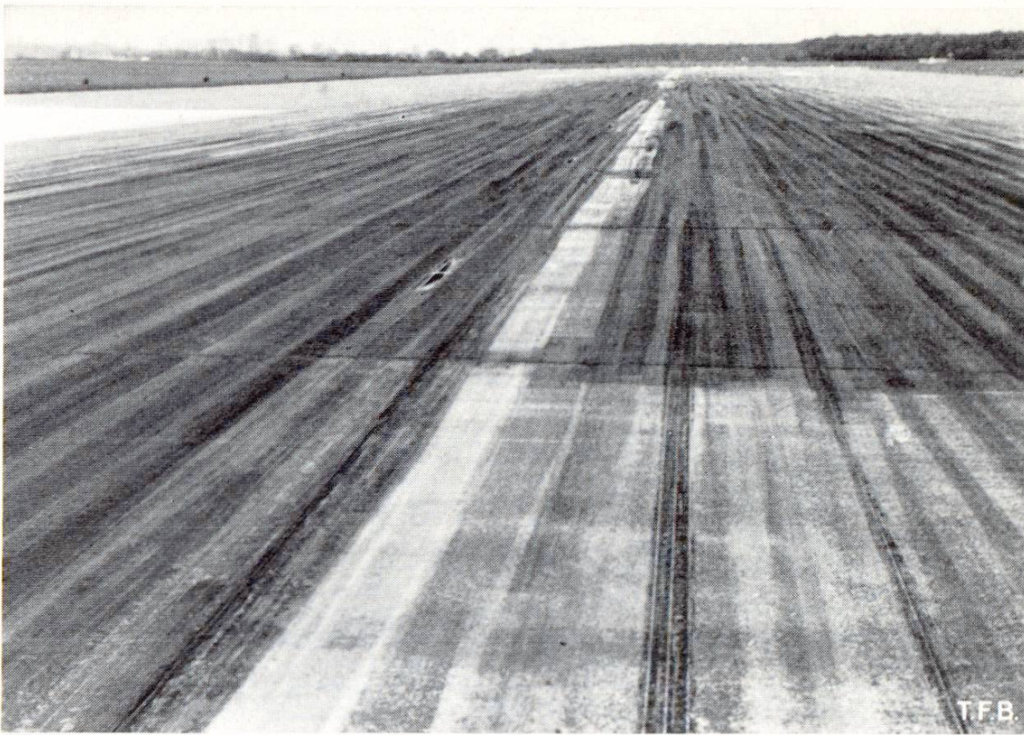
Fig. 3 Une zone de piste en béton recouverte de dépôts de caoutchouc. Au premier plan, à droite, une surface qui a été soumise au traitement, mais présente à nouveau les traces noires d'un avion ayant atterri depuis.
