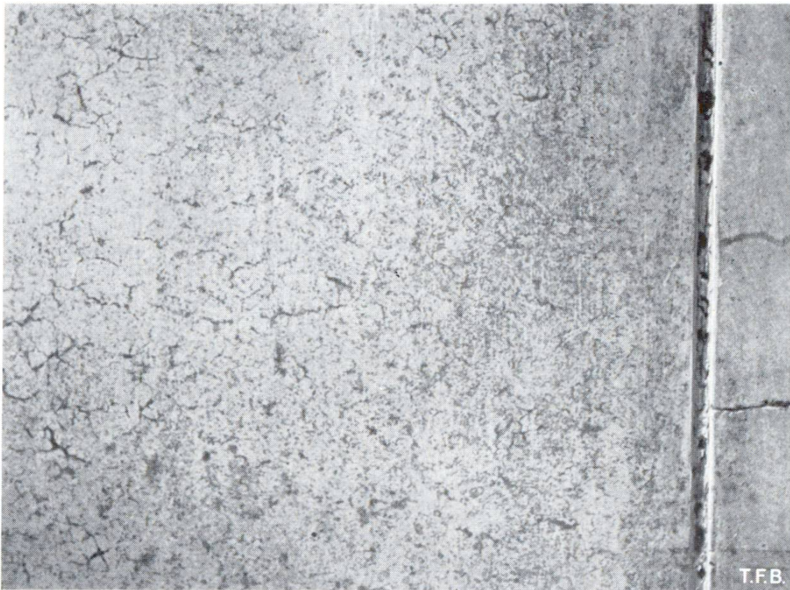
Fig. 2 Fin réseau de «fissures de retrait précoce» formé sous un coffrage lisse et imperméable. Au bord, il y a moins de fissures.
