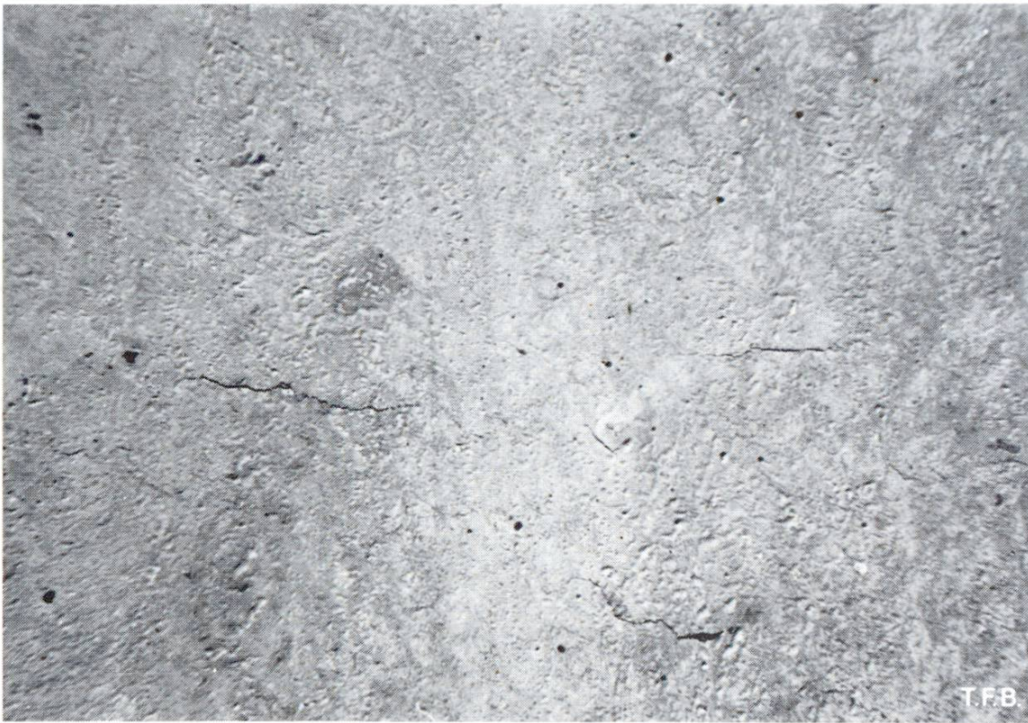
Fig. 3 «Fissures de tassement» dues à un glissement du «béton jeune» entre ses coffrages.
