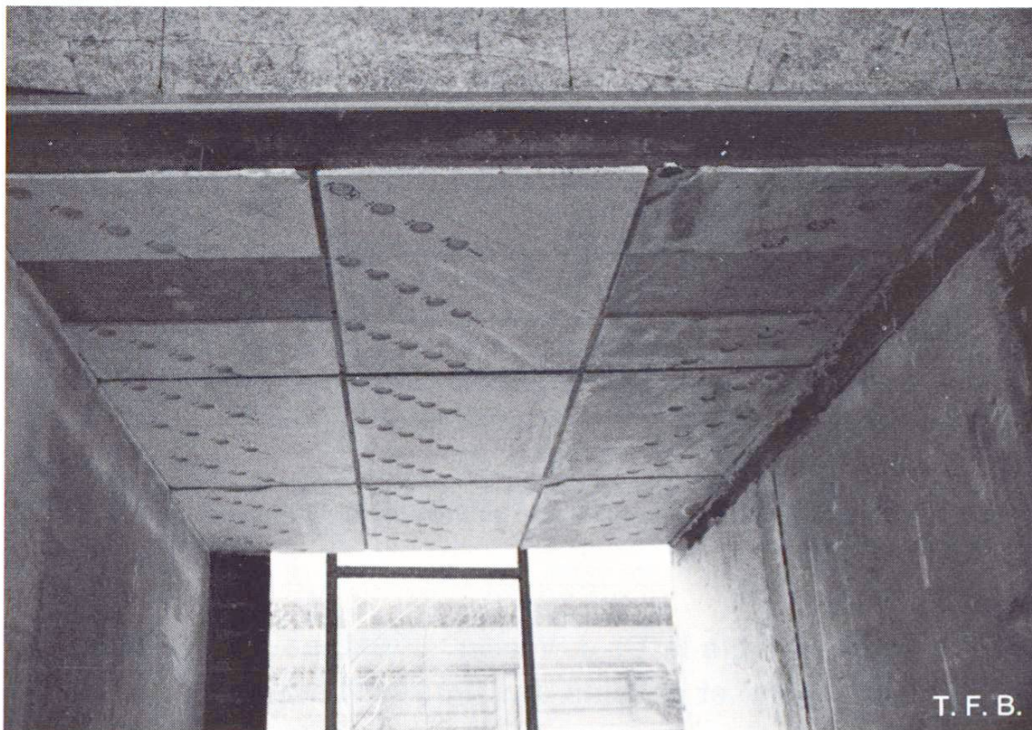
Fig. 14 Sur les surfaces d'essai sans produit d'accrochage, les enduits de plâtre se sont détachés d'eux-mêmes, après 3 mois pour celui de gauche et après 10 mois pour celui de droite. L'enduit du milieu n'est pas encore mort, mais il est bien malade!
