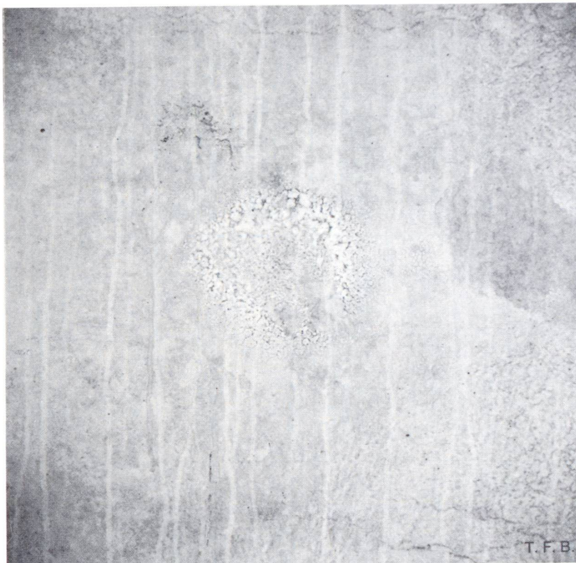
Fig. 3 Une huile de coffrage liquide, prisonnière entre le béton et le coffrage horizontal, est dispersée par la vibration en petites gouttes qui laissent des marques à la surface du béton
