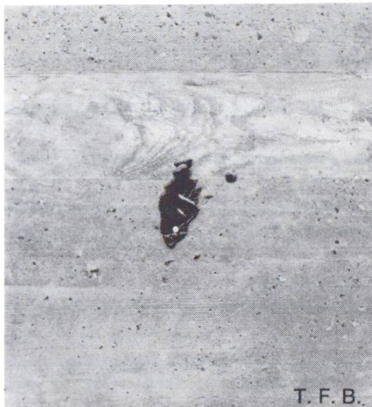
Fig.1 Surface de béton avec tache de bitume.
