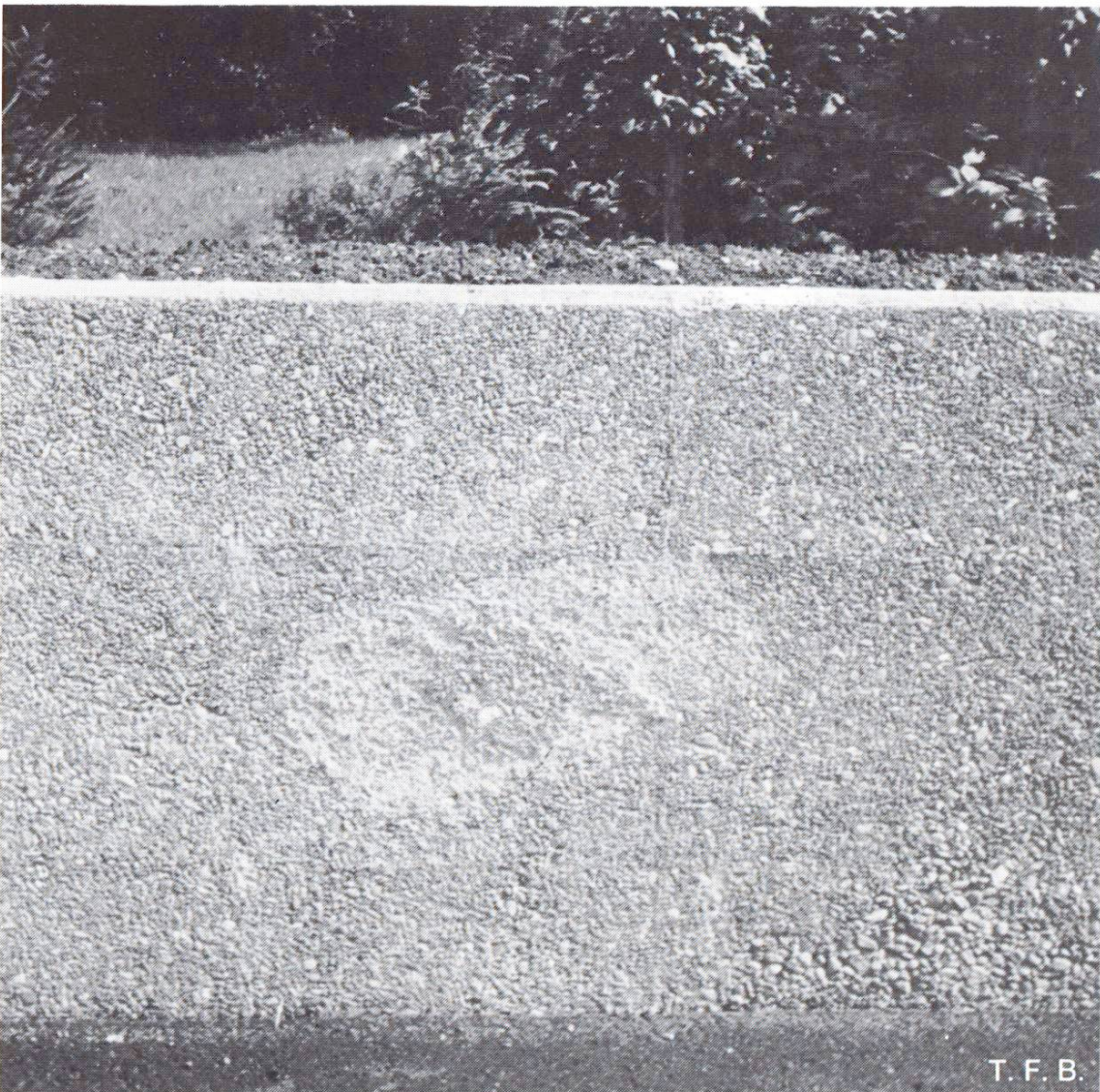
Fig. 2 Il est particulièrement difficile, voire impossible, de reconstituer l'aspect d'un béton lavé.
