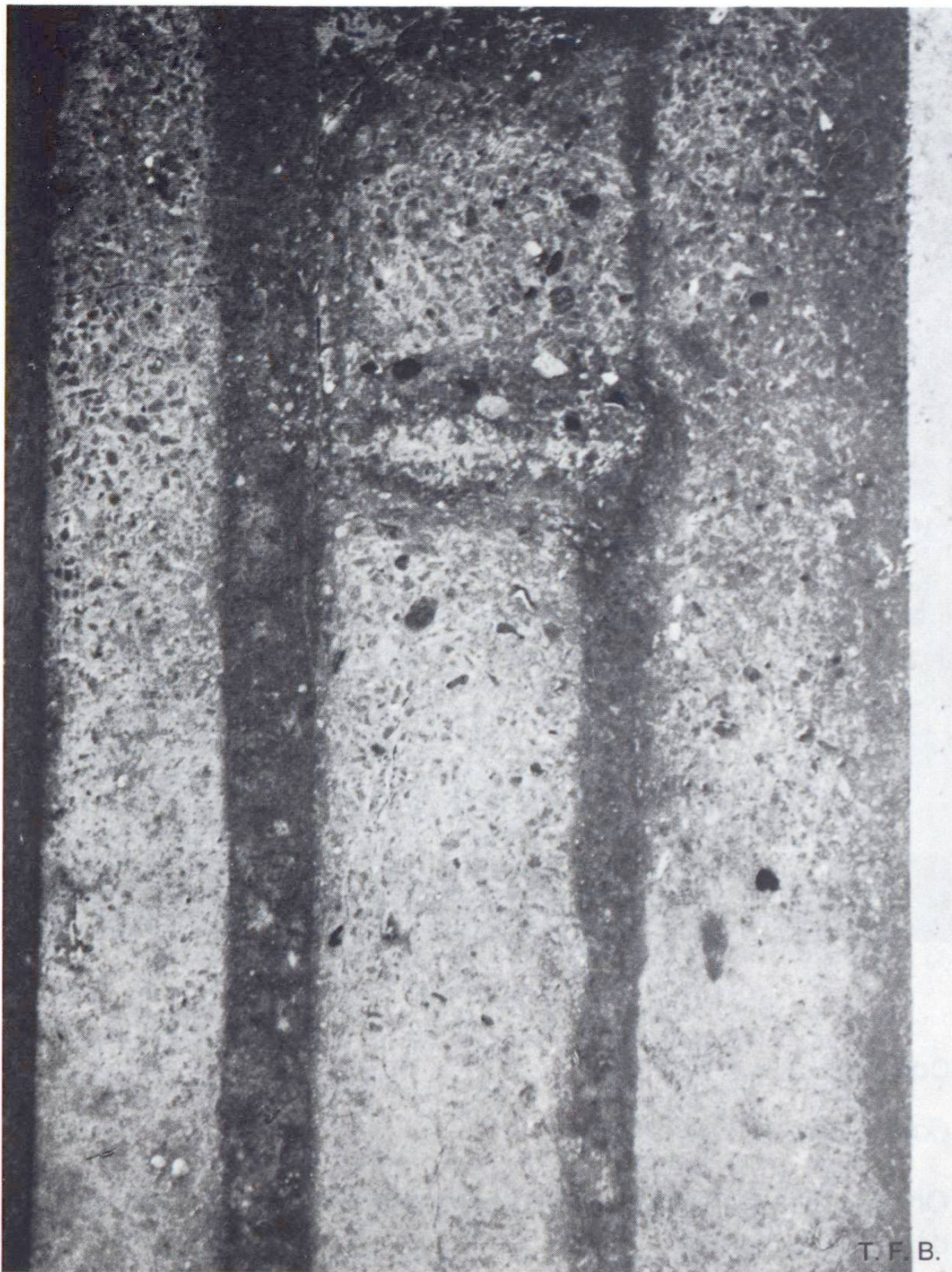
Fig. 10 Béton poli présentant des défauts en raison d'une ségrégation due au manque d'étanchéité du coffrage.
