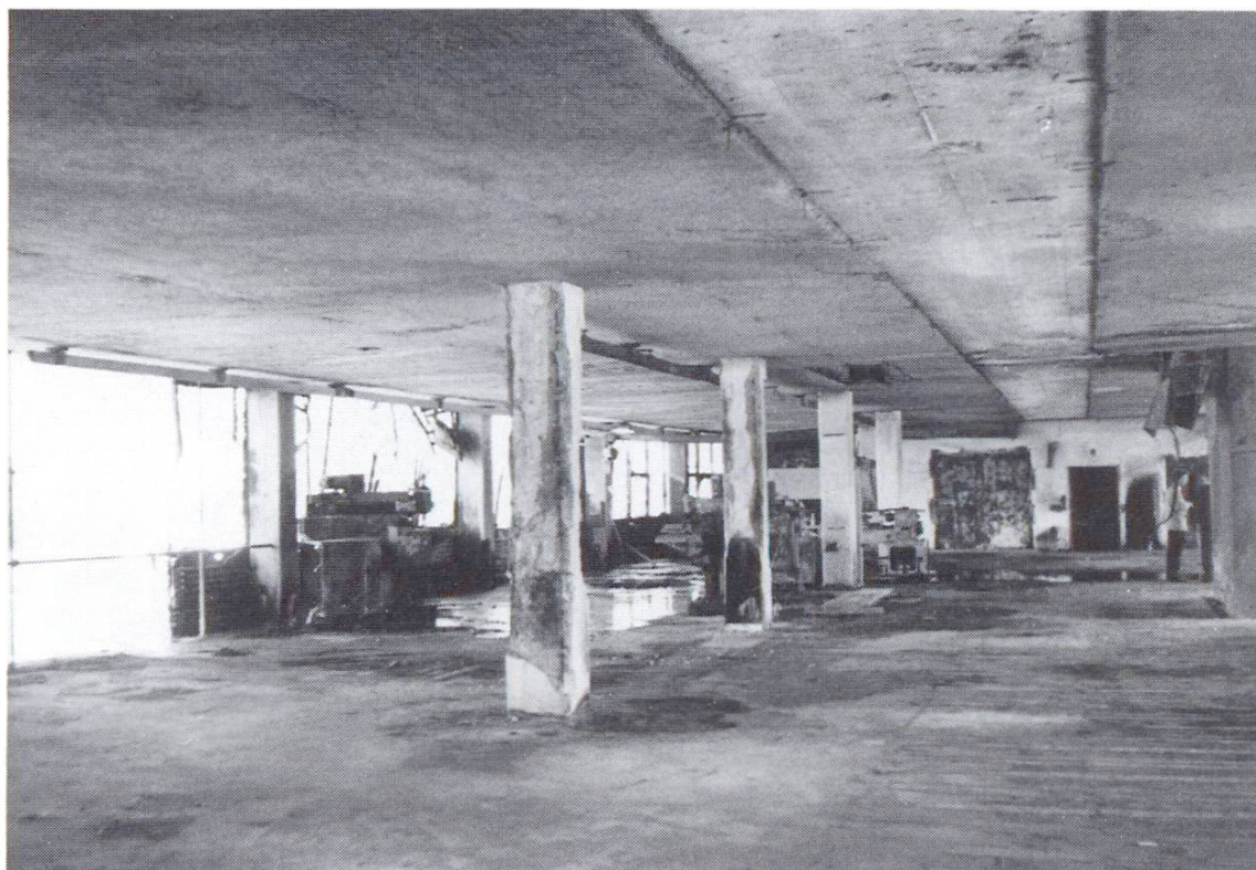
Fig. 2. Vue intérieure du bâtiment incendié de la figure 1 .
