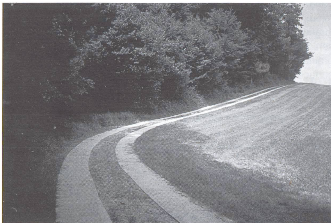
Bandes de roulement réalisées en 1991 près de Krauchthal, dans le canton de Berne.
