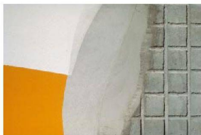
Enduit de protection faisant partie d'un reprofilage: barbotine d'accrochage, mortier de reprofilage, mortier d'égalisation et enduit.
