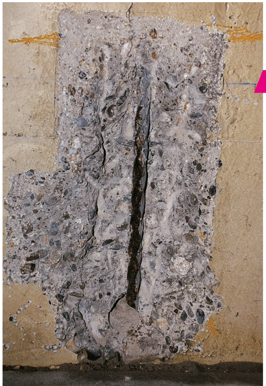
Le fer d'armature est corrodé du côté de la fissure.
