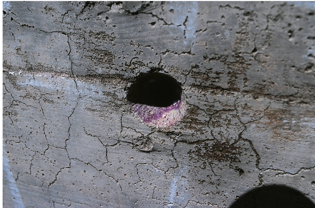
Cause des fissures: traitement de cure insuffisant.
