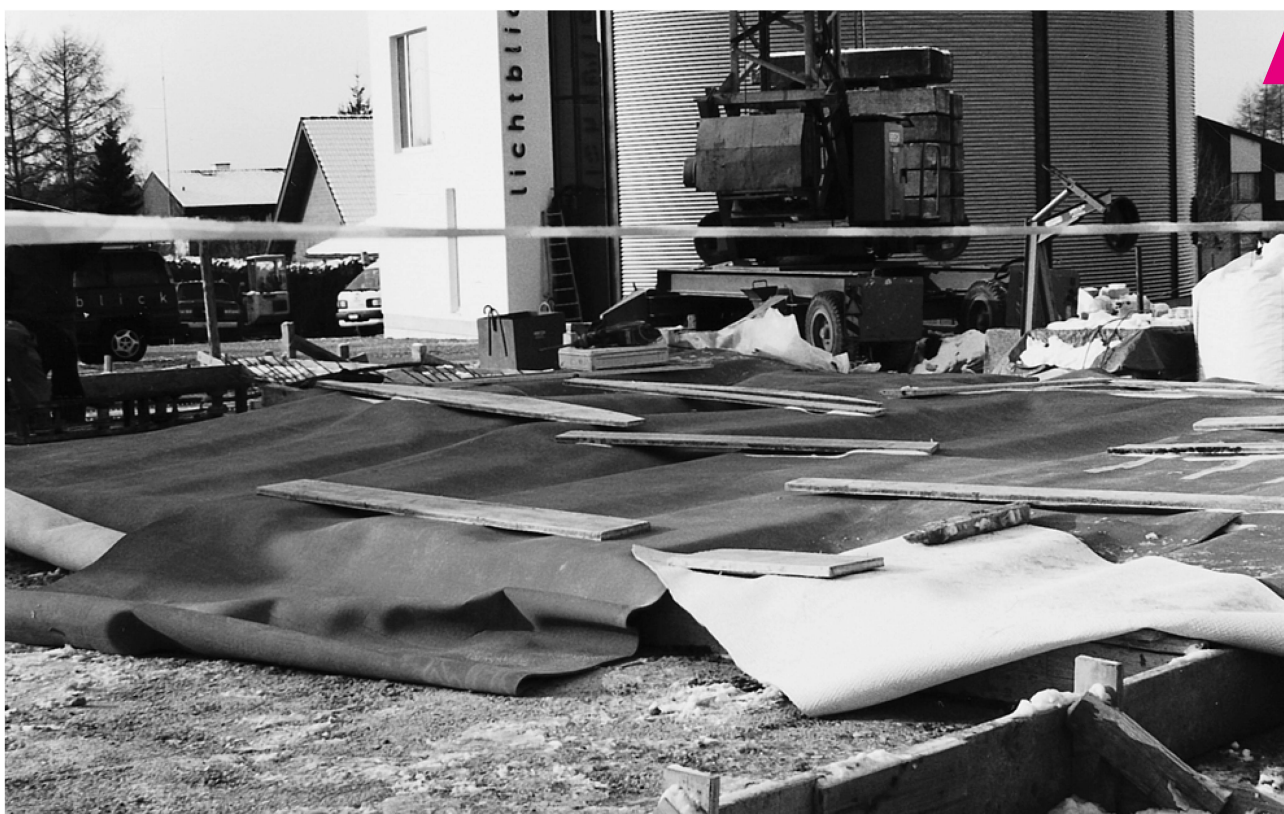
Dalle de fond fraîchement bétonnée protégée contre le froid et les courants d'air.
