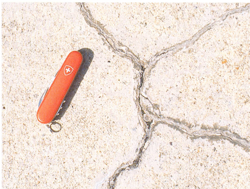
Fig. 6 Dégâts dus à la RAG sur le couronnement d'un barrage. Les fissures contiennent du gel de silice (foncé).
