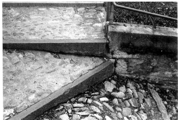
Abb. 38. Fugen mit Mörtel ausgegossen (Fugenbildet unschön, da Steinanteil sinkt und Fugenanteil wächst).
