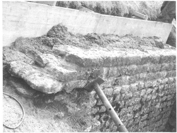
Fig. 4. Amphithéâtre. Le mur de fond de la cage d'escalier sud-est, naguère rehaussé, a dû être réparé et doublé d'un arrière mur de béton pour résister à la poussée des terres de la cavea engazonnée (photo MRA).
