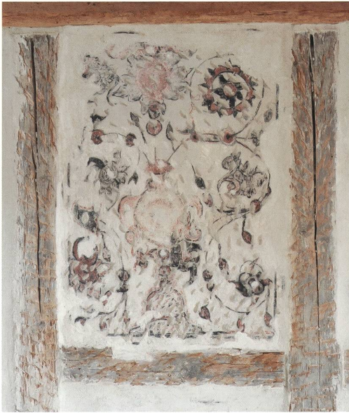
Die Malereien an einer Zwischenwand im zweiten Obergeschoss. Hat der damals in der Region bedeutende Maler und Kunstmaler Simon Schilplin auf diese Weise das Haus geschmückt? Foto: Marcel Werren, Brugg
