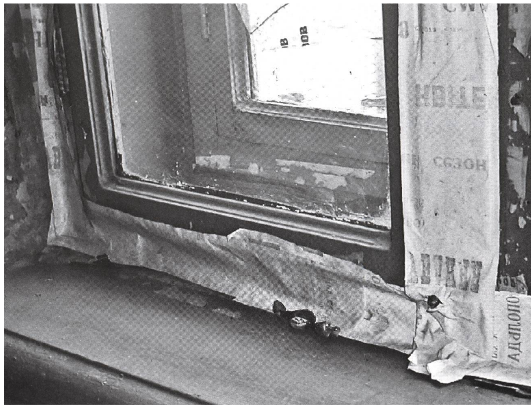
Diese Art von Isolation verdeutlicht den Zustand vorhandener Proberäume.
