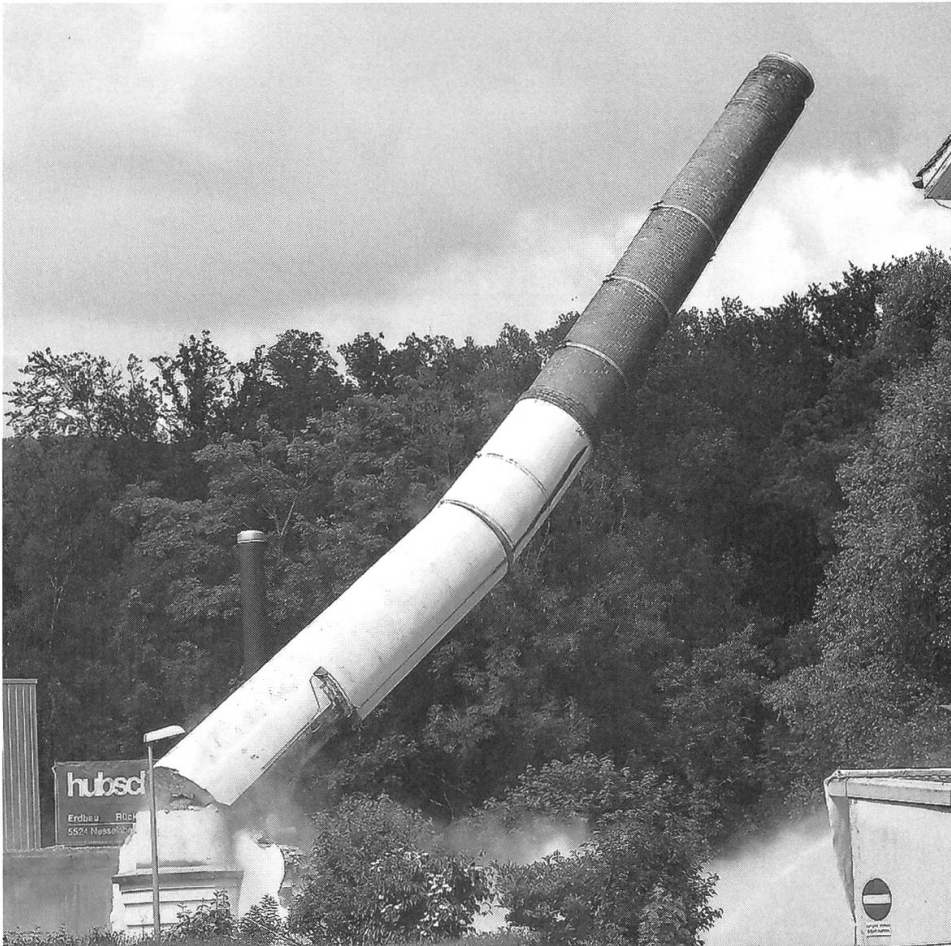
Ein Knall, der Kamin neigte sich und fiel genau in die vom Sprengteam vorgesehene Richtung. Ein Schauspiel von wenigen Sekunden.
