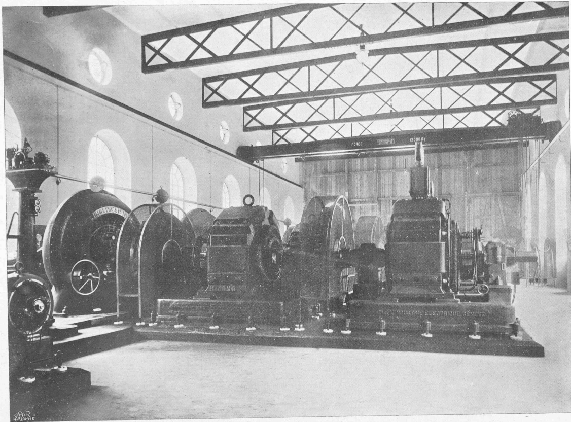
VUE INTÉRIEURE DE L'USINE DE ST-MAURICE ET D'UN GROUPE ÉLECTROGÈNE DE 1000 CHEVAUX
