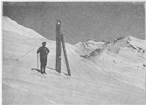
Fig. 2. — Le col des Andérets. Poteau de 12 m. Les 3 fils haute tension sont rompus, ainsi que les 2 fils téléphoniques. Le trait de lumière, à droite, en bas, marque le bord supérieur de la corniche.
