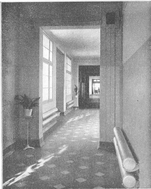
Fig. 3. — Chauffage d'un couloir par radiateur.
